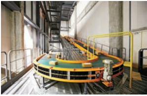
22 「関西ゲートウェイ」でのスパイラルコンベア。上層階で流通加工した荷物を仕分けエリアに直結させ、作業時間を短縮
