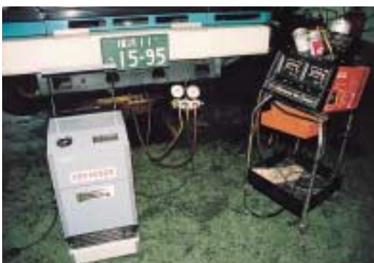
フロンガス回収装置
