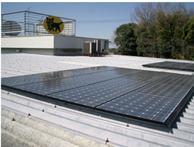
豊田松平支店の屋根上に設置された太陽光パネル
