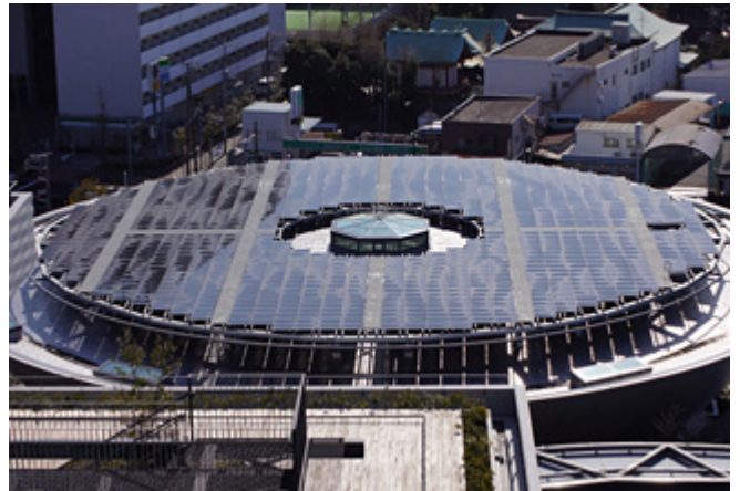
羽田クロノゲート内フォーラム棟の太陽光パネル
