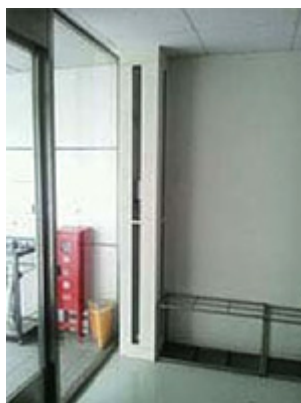
エアカーテンの設置によって外気を遮断 (ヤマトシステム開発)
