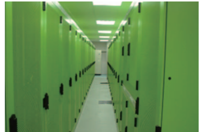
新東京IDC(上)とサーバールーム(下)
